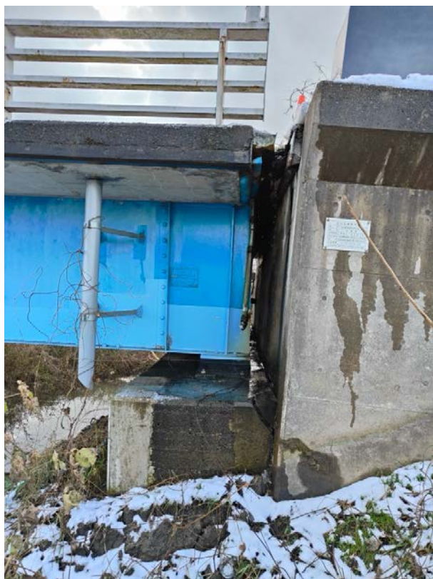
写真10 北側（河北潟側）橋台の支承付近の状況（縦壁，支承，上部工に損傷はない，パラペットの根本にひび割れが発生しており，右側に傾いている。）
