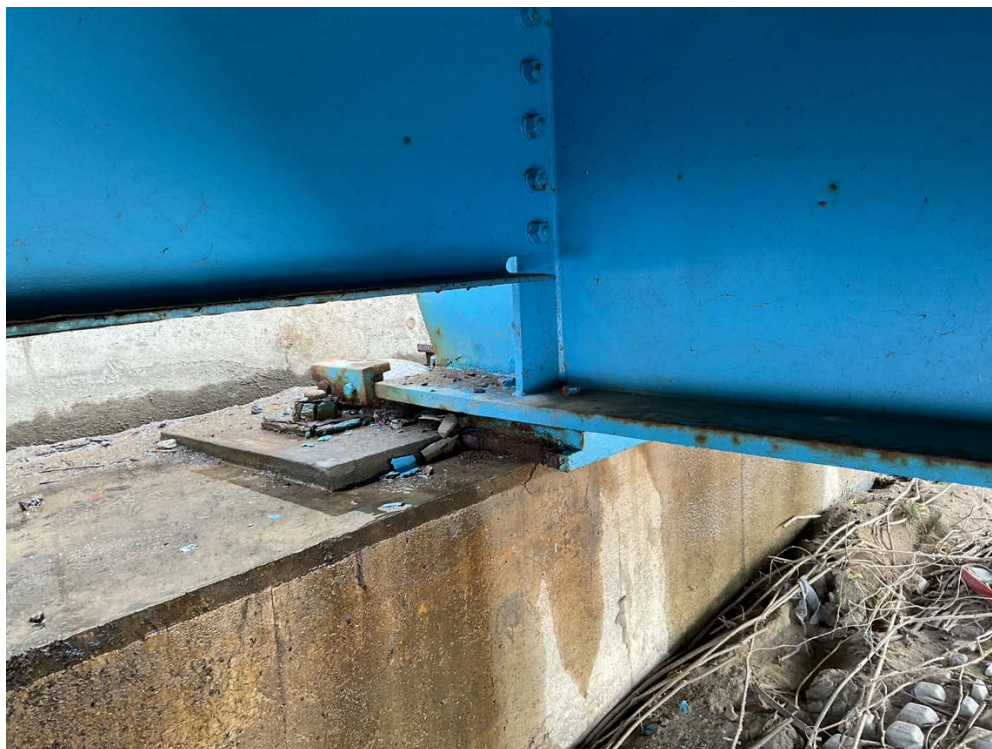
写真5 西側橋台の支承部の損傷状況（鋼桁が右側に移動し，支承が破壊している.）
