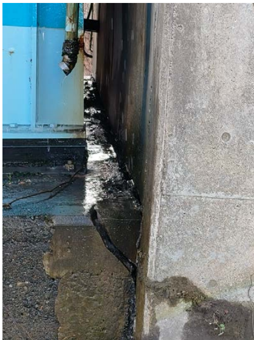
写真11 パラペットの根本の拡大写真（ひび割れが発生している。）
