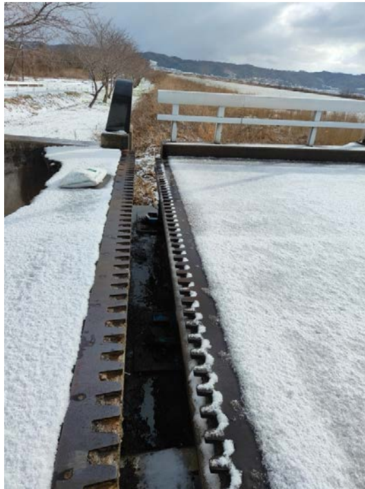
写真4 東側（河北潟側）の橋台部のジョイント（約 50cm 開いている。原因は桁が支承
