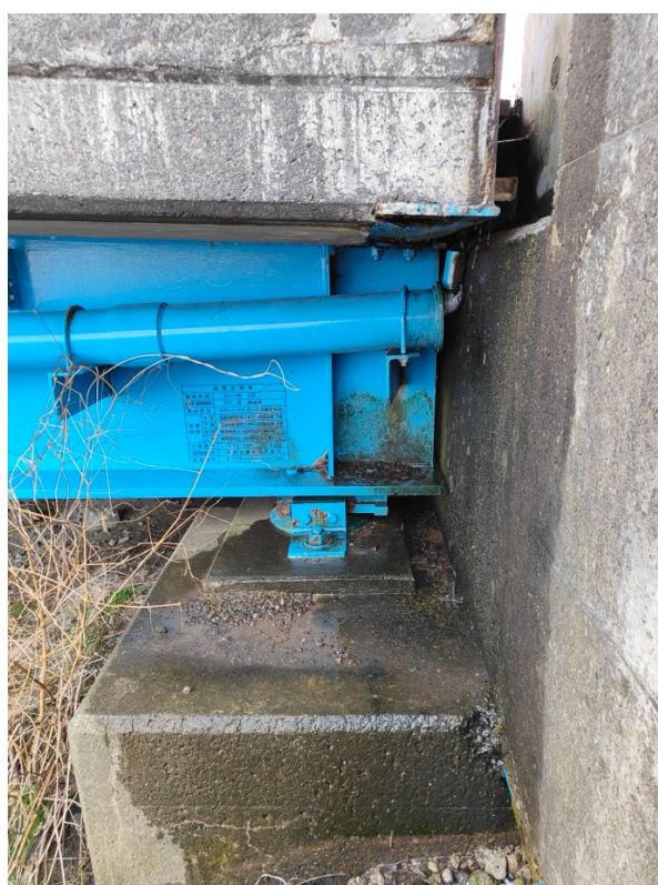
写真2 西側橋台の支承部（橋桁は右側に動いており、ジョイントがせっている。橋台側が可動軸。可動範囲いっぱいまで移動していることがわかる。）
