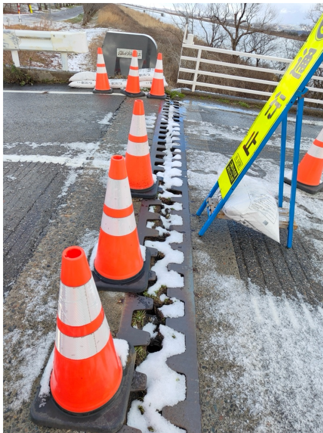
写真9 ジョイントの状況（目開きは15cm程度）
