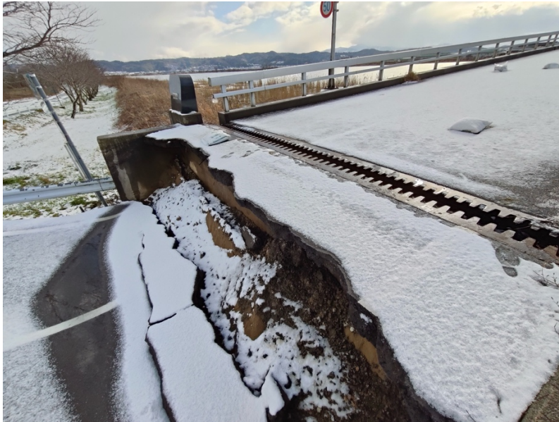
写真7 西側橋台の背面の状況（約 1.4m の段差が生じている．元々あった裏込土がどこにいったのかが見当たらない）
