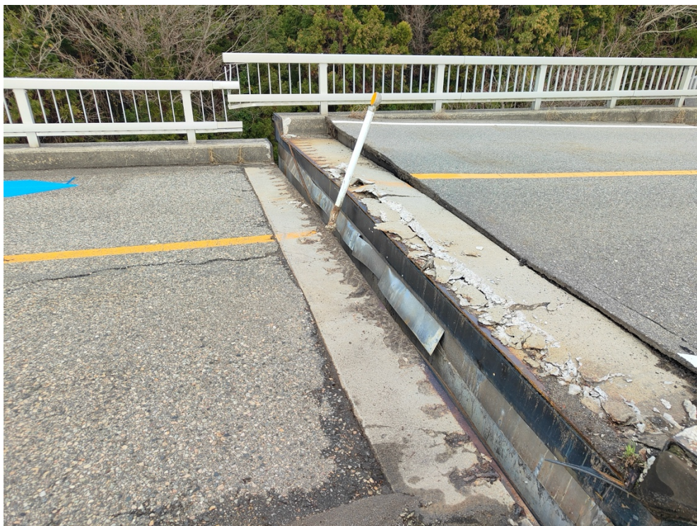
写真2 能登島側橋台に生じた路面段差（左側が橋梁上部工で右側が橋台および背面、約40cmの段差が生じている。）
