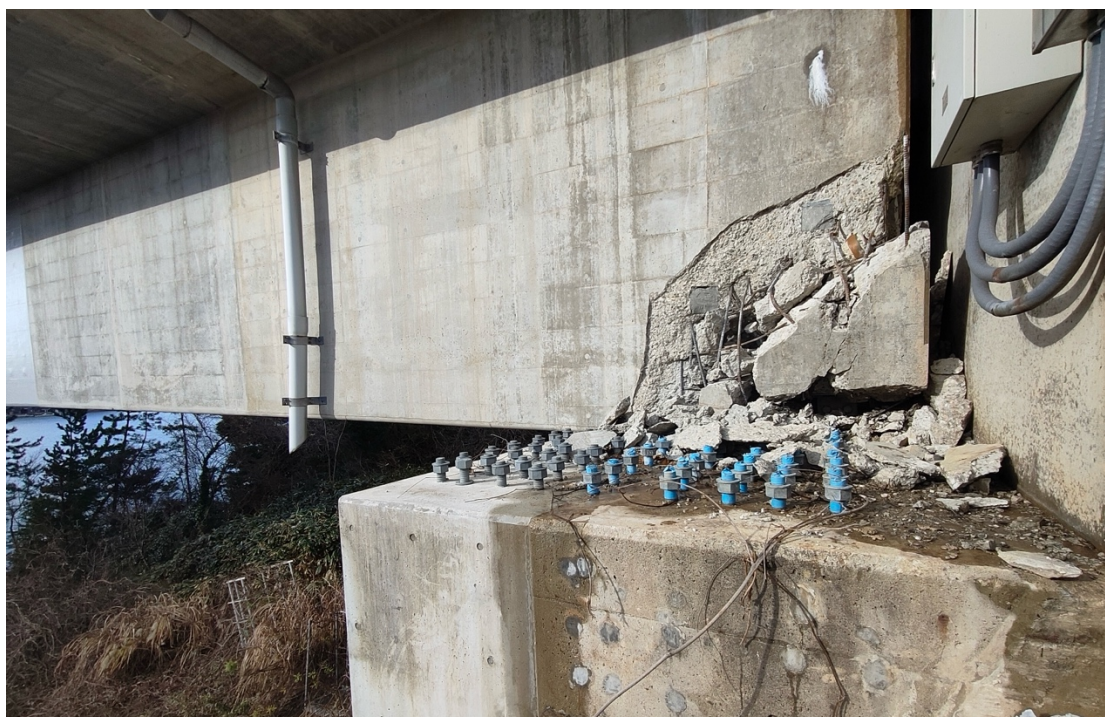
写真3 能登島側橋台の支承部の損傷状況（支承部のコンクリートが破壊している。）
